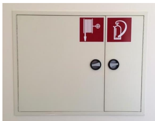
Abb. 4.4.1: Wandhydrantenkasten (hier mit Feuerlöscher kombiniert)
